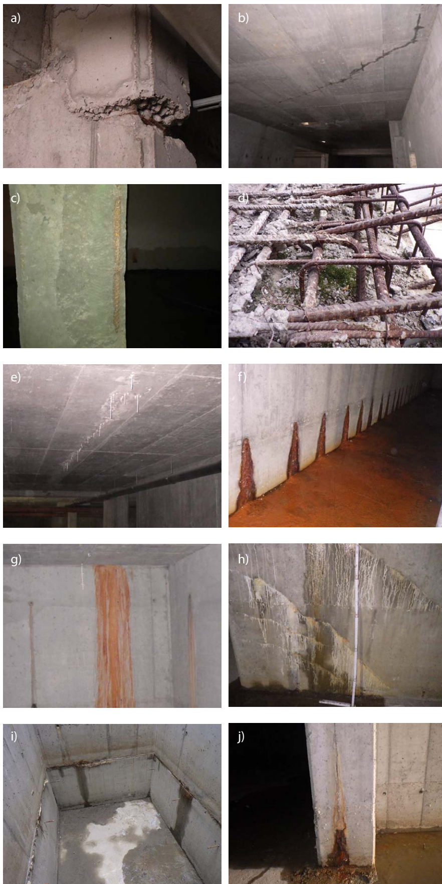
Rys. 1. Przykładowe uszkodzenia konstrukcji części podziemnej budynku stwierdzone w momencie przejmowania obiektu przez drugiego inwestora, opis w tekście (fot. własne)
