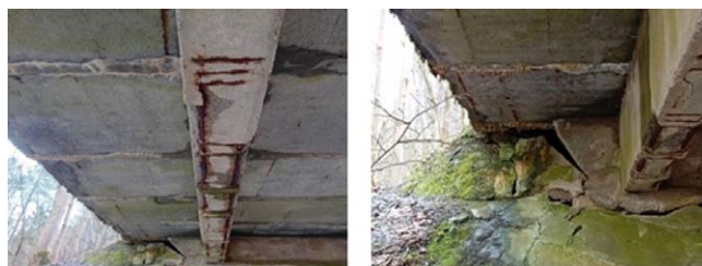
Rys. 3. Uszkodzenia elementów nośnych obiektu mostowego [15]
